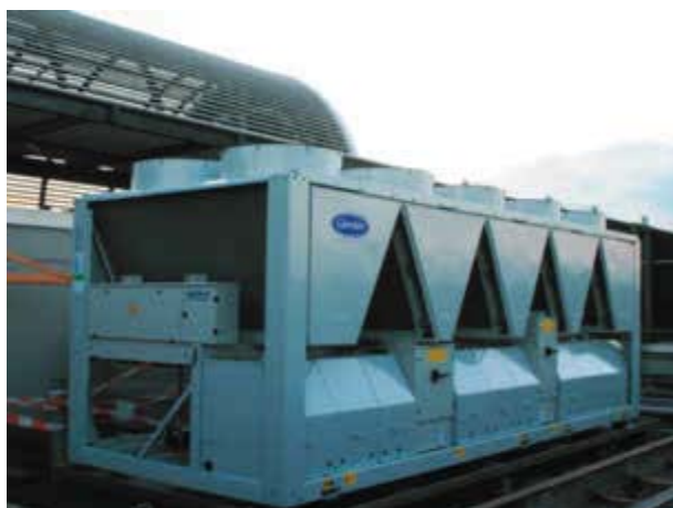
Bild C-2 Beispiel für Anlagen auf dem Dach installierter luftgekühlter Kühlaggregate von Kälteanlagen mit Auffangflächen und Abflüssen > 1/s in die Schmutz- oder Mischwasserkanalisation (Bild aufgenommen vor Inkrafttreten der AwSV) Carrier Kältemaschine 30RB672 mit Scroll-Kompressoren, Aufstellfläche ca. 15 \text{ m}^2 Werkbild: Carrier Klimatechnik GmbH, Ismaning
