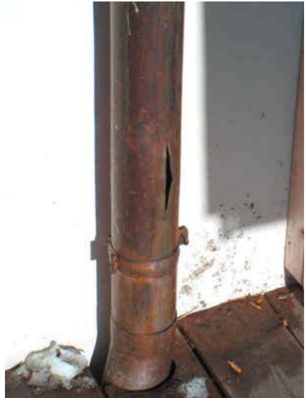
Bild 6-72 Durch Frosteinwirkung beschädigtes Regenfallrohr
