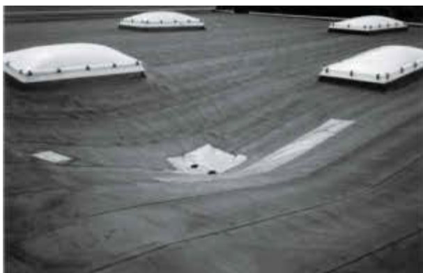
Bild 5-32 Verformung einer Dachkonstruktion durch unzulässige Überflutung der Dachfläche
