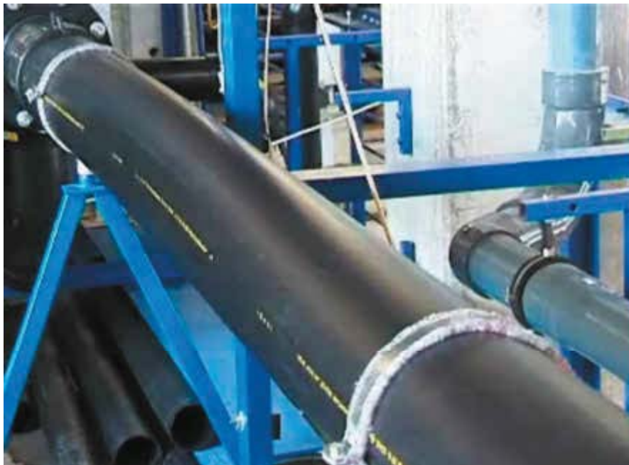
Bild 14-85 Verformung einer Rohrleitung durch unzulässigen Innendruck in einer Versuchsanlage der Fachhochschule Münster
