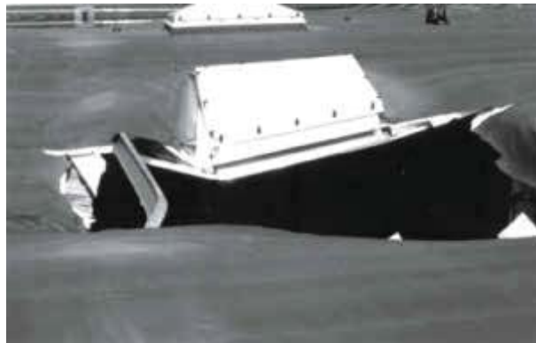
Bild 5-33 Einsturz einer Dachkonstruktion durch unzulässige Überflutung der Dachfläche
